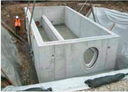
Bild 5.20: Regenüberlaufbauwerk, FBS-Schachtbauwerk aus Stahlbetonfertigteilen
