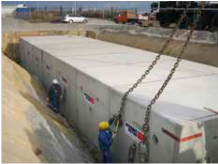
Bild 5.1: Löschwasserbehälter, FBS-Stahlbetonrohr mit Rechteckquerschnitt
