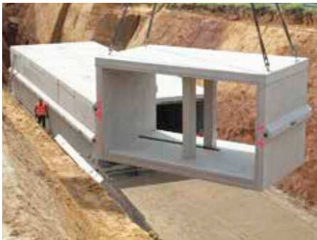
Bild 5.22: Sedimentationsanlage, FBS-Stahlbetonrohre mit Rechteckquerschnitt
