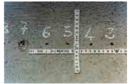
Bild 5: Geringfügige Auswaschungen an einem Betonrohr – Prüfkart „Deblocking“ [1]
