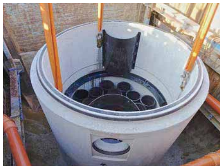
Bild 5.23: Filter- und Sedimentationsschacht, FBS-Schachtbauwerk rund
