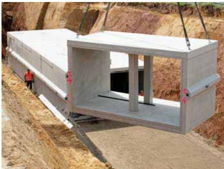
Bild 5.22: Sedimentationsanlage, FBS-Stahlbetonrohre mit Rechteckquerschnitt
