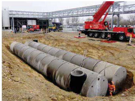
Bild 5.2: Löschwasserbehälter, FBS-Stahlbetonrohr mit Kreisquerschnitt
