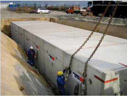
Bild 5.1: Löschwasserbehälter, FBS-Stahlbetonrohr mit Rechteckquerschnitt
